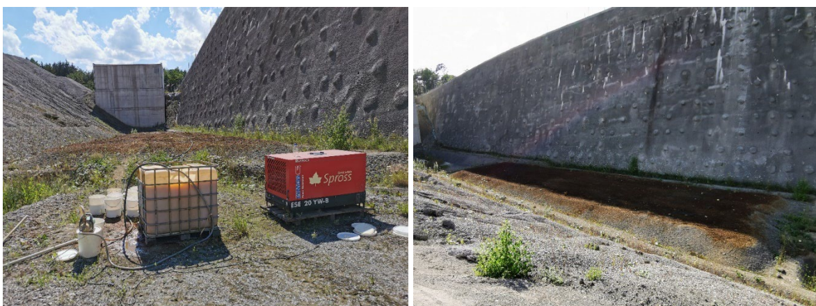
Abb. 3.5: Links: IBC mit Eisensulfatlösung und Pumpe
