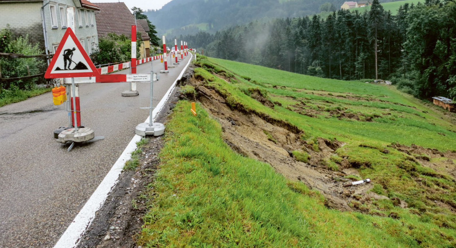
Heftige Unwetter lösten am 28. Juli 2014 unterhalb einer Strasse in Reute (AR) mehrere Hangmuren aus.
