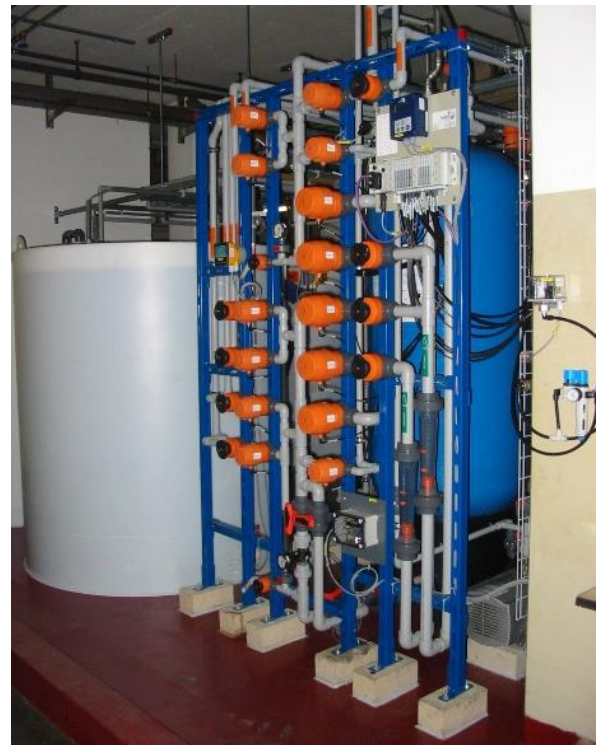
Abbildung 19: Anlage zur Chromsäure-Reinigung ohne Spülwasser-Verdunster
