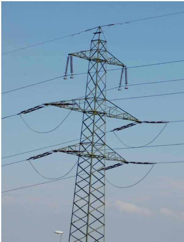
Abbildung 19: Mast mit doppelten Hängeketten an der oberen, und Abspannketten an der mittleren und unteren Traverse (Mast Nr. 44).
