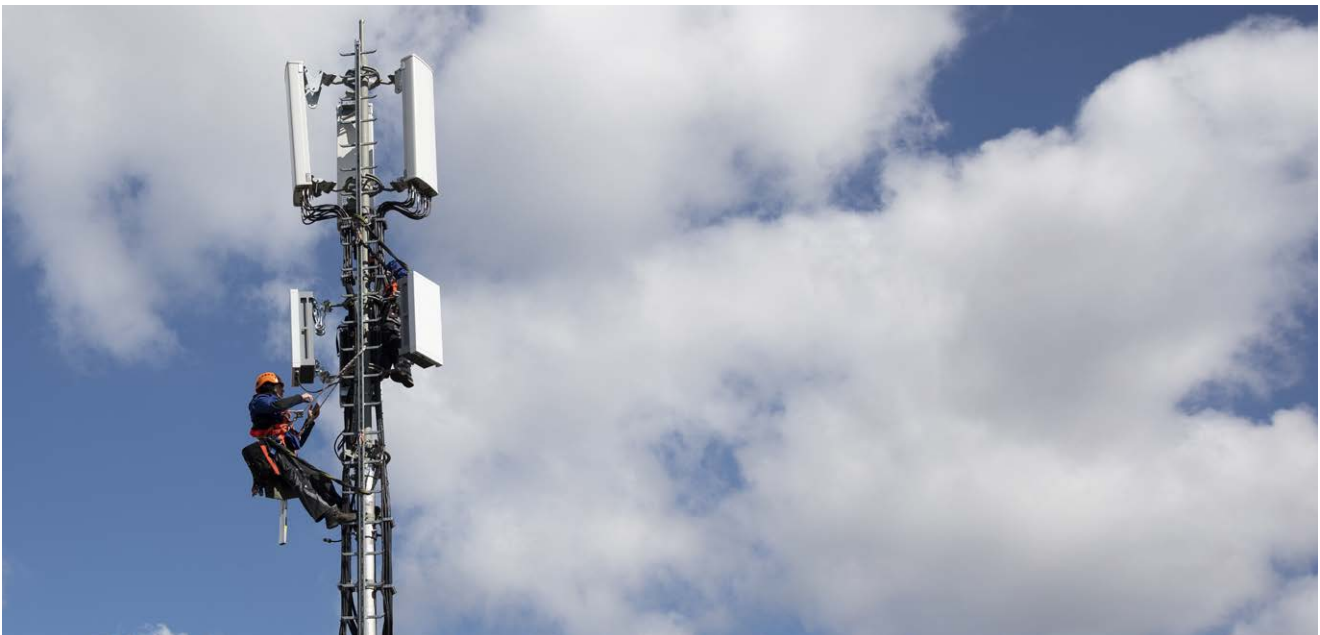
Installation einer 5G Antenne in Bern
