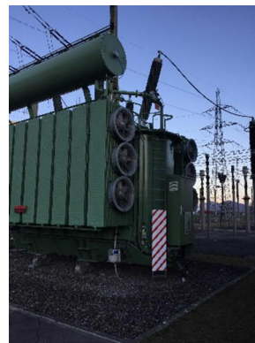
Seitenansicht: Ventilatoren und Schaltelemente des Trafos
