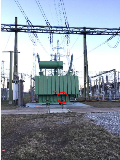
Trafo 1 mit Referenzmikrofonposition (rot markiert)
