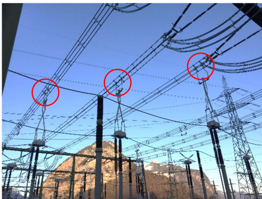
rot markiert: Ort der Lichtbogengeräusch- entstehung bei den Schaltvorgängen
