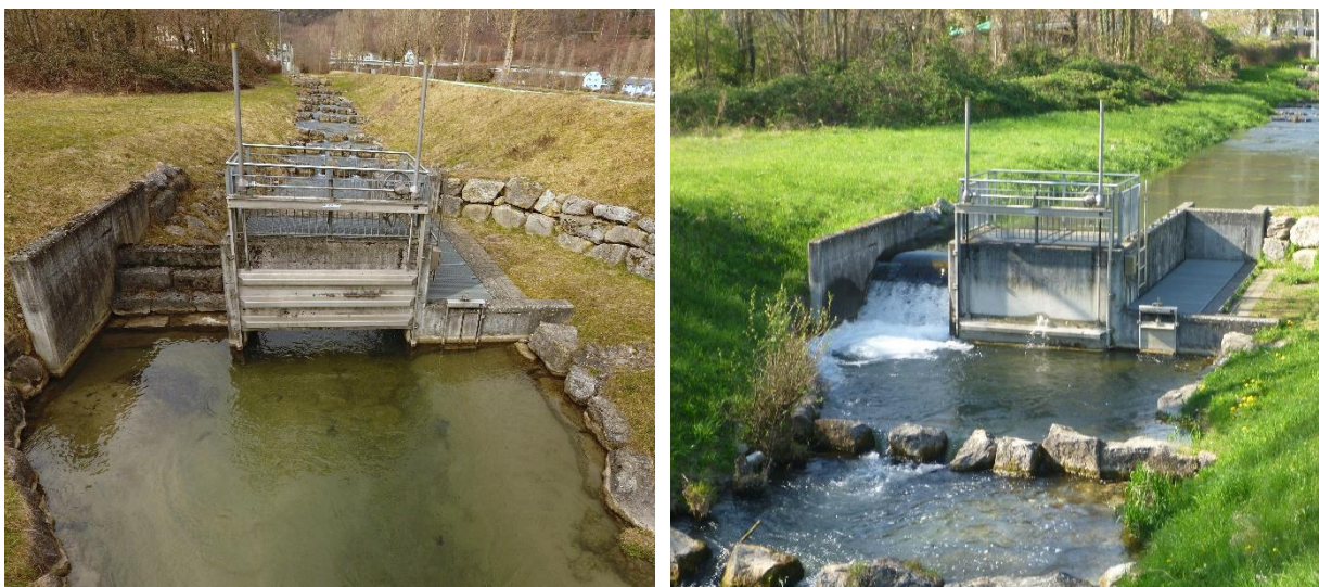
Abbildung 2: Zählbecken Winznau mit geöffnetem (links) und geschlossenem (rechts) Schütz. Bei geschlossenem Schütz strömt das Wasser über den Überfall links im Bild und durch das Zählbecken auf der rechten Seite.
