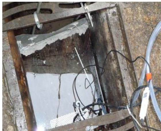
Abb. 3 Installation im Kontrollschacht der Sickerwasserleitung am RBL (Fließrichtung von unten nach oben). Oben das Wehr aus Aluminiumblech (V-förmig eingeschnitten), unten Lf-Sonde und Lochblech zur Befestigung der Ultraschallsonde sowie Pumpschlauch und Zuleitungskabel für die Sensoren.
