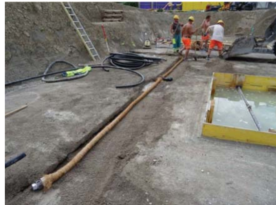
Tuyaux et coffrages pour l’aspiration
