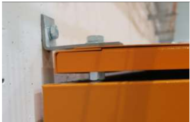
Sécurisation d'une armoire de commande (image OFEV)
