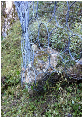
Fig. 1: Blocs et pierres retenus par un filet de protection (Source: Bernard Loup)
