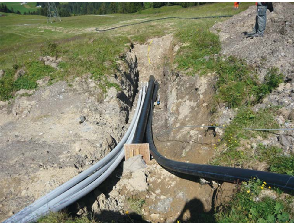
Fig. 11 > La construction de conduites d'alimentation des installations de production de neige peut porter atteinte aux milieux naturels et aux sols.
