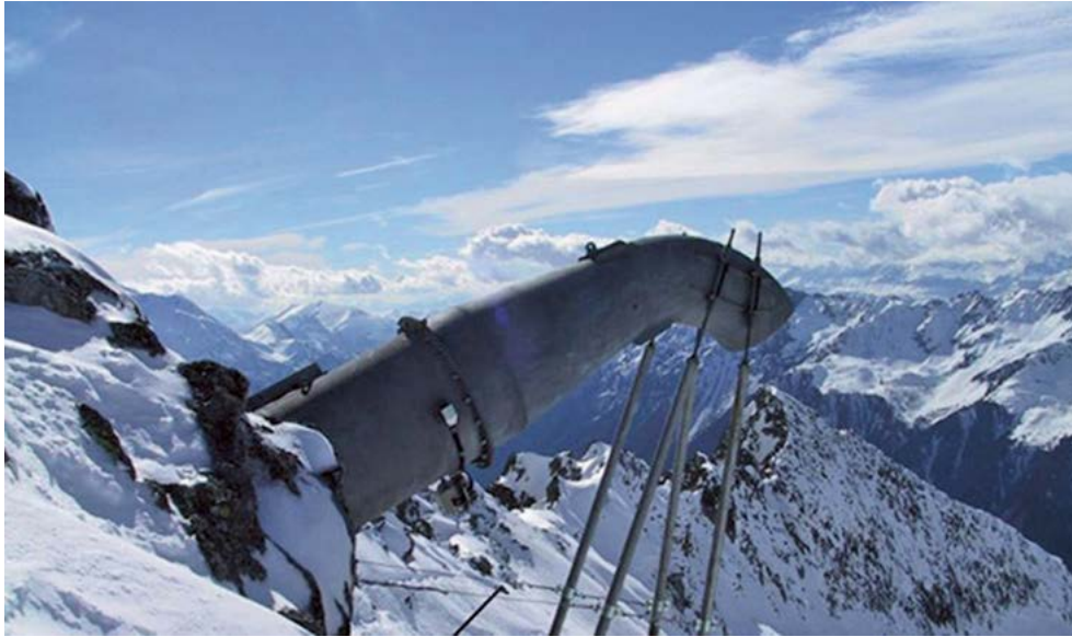
Fig. 13 > Installation fixe de déclenchement d'avalanches par explosion de gaz (dispositif «gazex»), © TAS.
