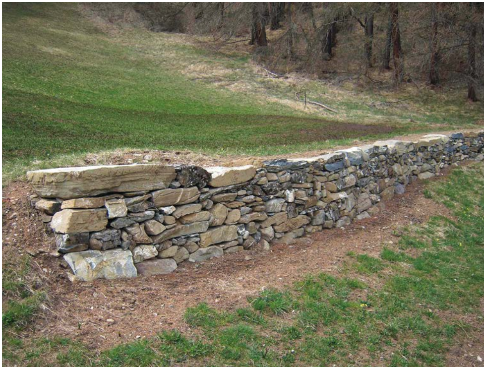
Fig. 35 > La restauration d'un mur de pierres sèches peut être une mesure de remplacement intéressante, tant pour l'écologie que pour le paysage.
