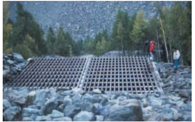
Cours d'eau aménagé en zone montagneuse en vue d'une protection contre les laves torrentielles. Ce brise-lave retient les matériaux charriés et laisse passer l'eau.
