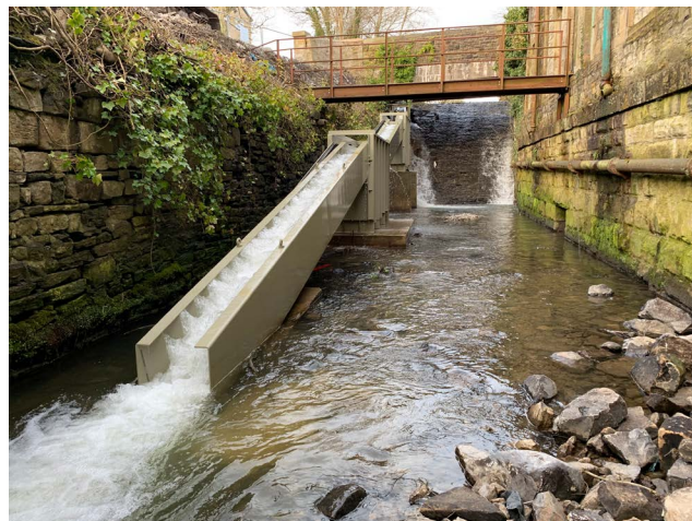
Fig. 25 : Passe à poissons Denil nouvellement installée sur la Mearley Brook, en Angleterre
