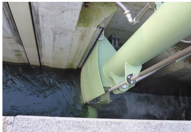
Fig. 52 : Zone d'entrée d'un by-pass avec une porte busquée en service Centrale de Rüchlig sur l'Aar (canton d'Argovie).
