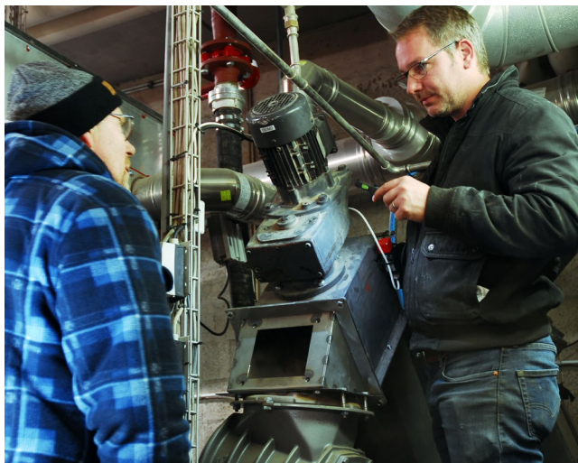
L'impianto Fireforce con una potenza di 500 kW Foto: André Van der Veken
