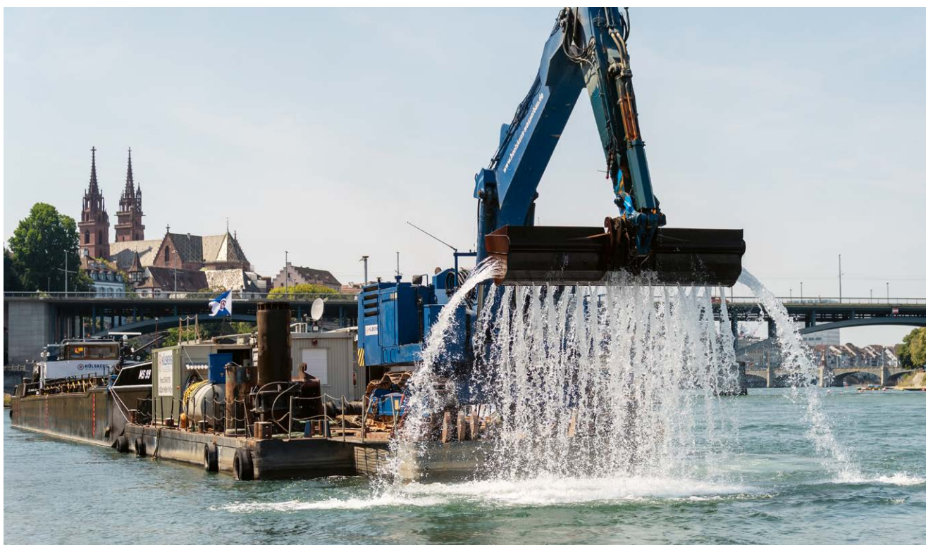
Fig. 32: Lavori di costruzione a Basilea per lo scavo del canale di navigazione nell'estate 2018
